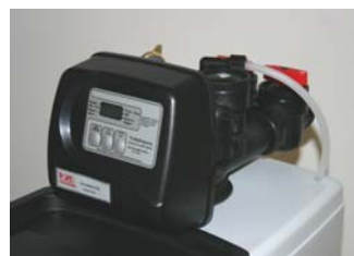
Bilden visar filterautomatik samt förbigångsventil, under den blå kåpan.
